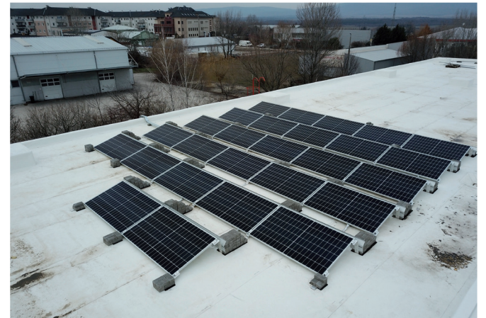
Elektro Center – Veszprém 10,2 kWp
