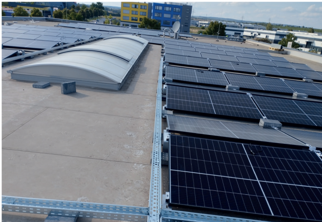
Easy Metal – Austria 245,5 kWp
