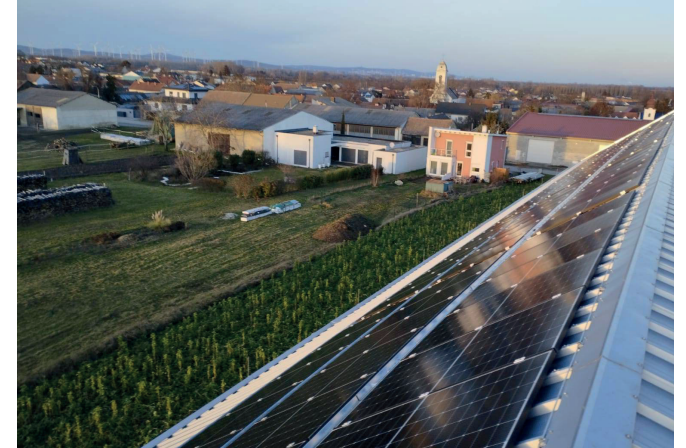
Ausztria – Zürndorf 190,755 kWp
