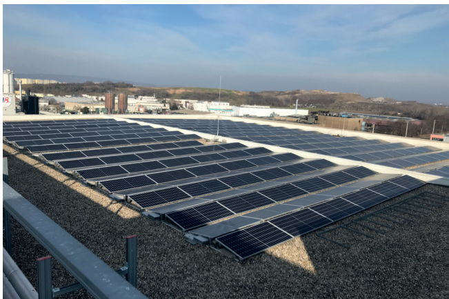
AUSZTRIA – TKL WIEN – 1200 KWP NAPELEM RENDSZER
