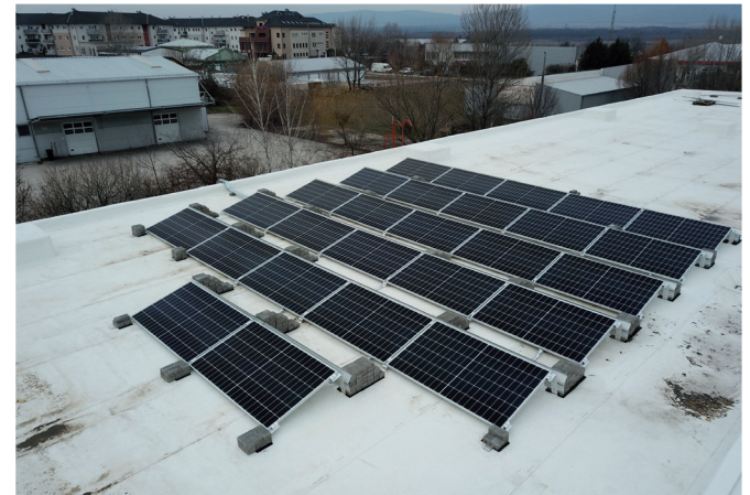
Elektro Center – Veszprém 10,2 kWp
