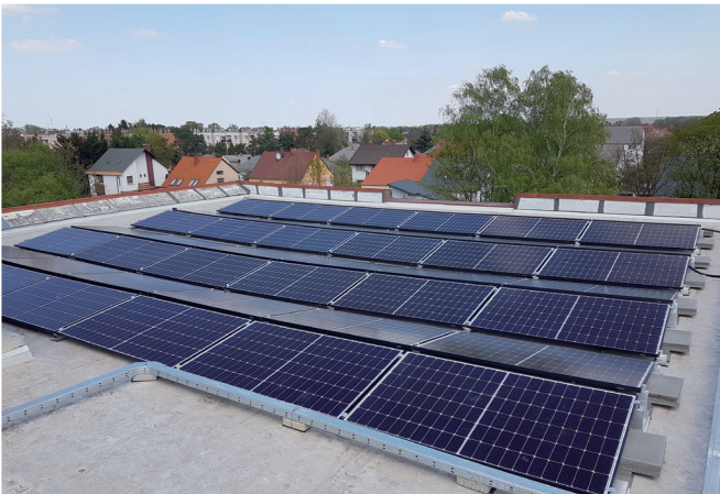
Celldömölk – Vasvirág 27 kWp
