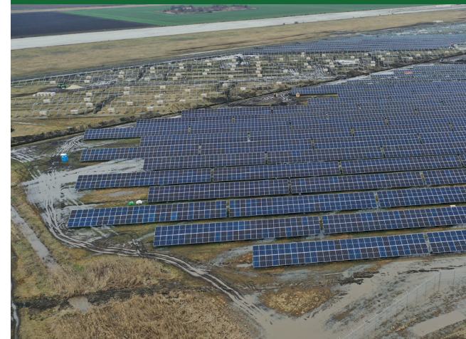
KUNMADARAS NAPELEMPARK – 57,6 MW – EBBŐL 12,49 MWP RÉSZT VÁLLALTUNK
