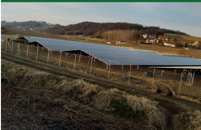
AUSZTRIA – HOHENBRUGG 824 KWP + 999 KWP SOLAR EDGE TERMELEÉS OPTIMALIZÁLT FÖLDI TELEPÍTÉSŰ NAPELEM RENDSZER
