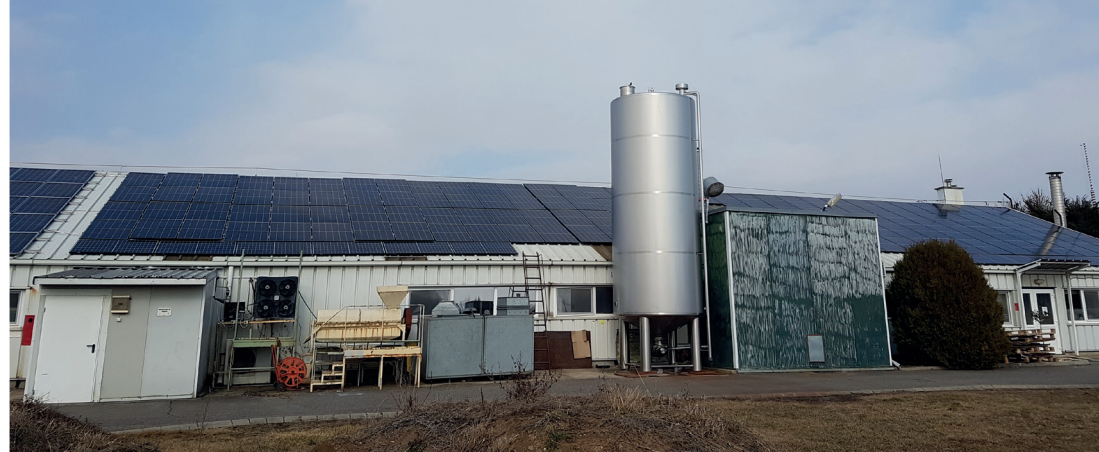
Bodrogkeresztúr – Bergland Kft. – 160 kWp
